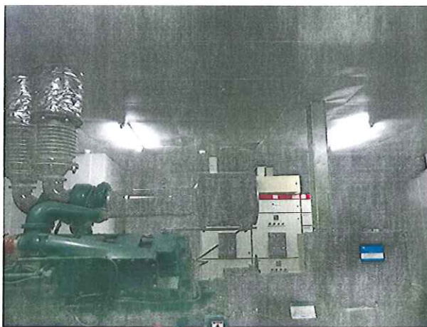
项目发电机房
